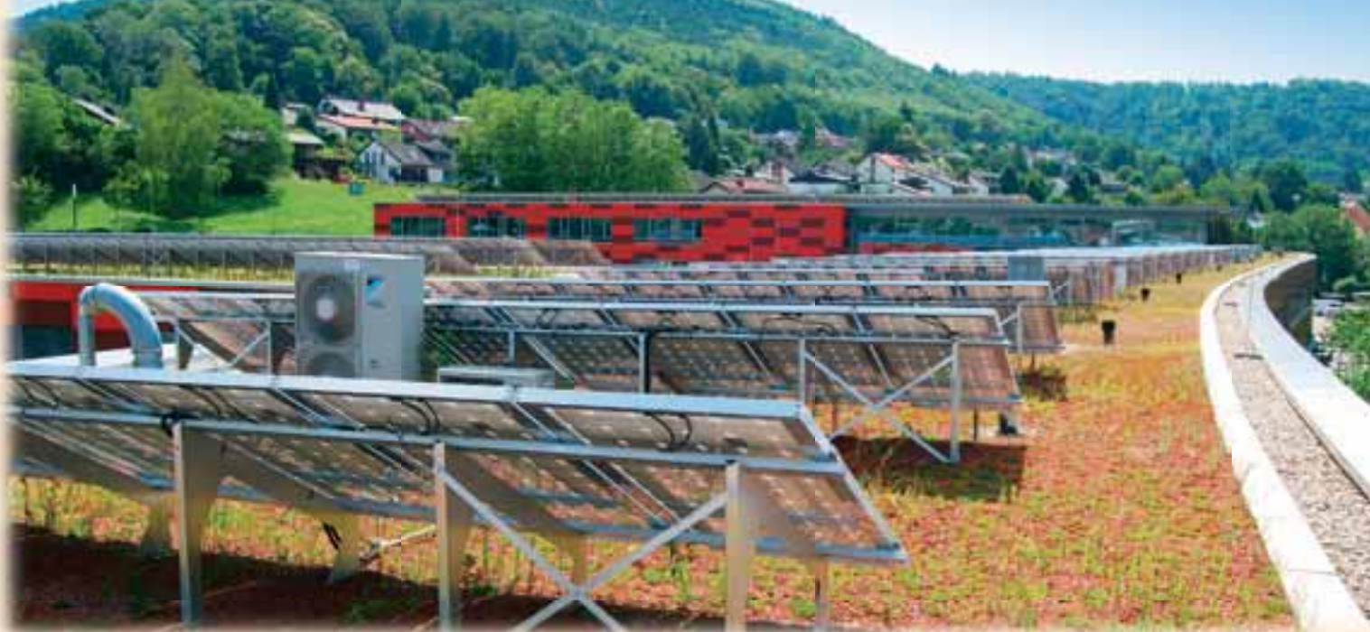
Photovoltaik-Anlage auf einem Schulzentrum in Neckargmünd
