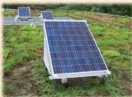
Hierbei wurden zwei Module über „nackten“ Bitumenbahnen einem Modul über einer Dachbegrünung gegenübergestellt. Hauptaugenmerk galt den jeweiligen Tempera-
